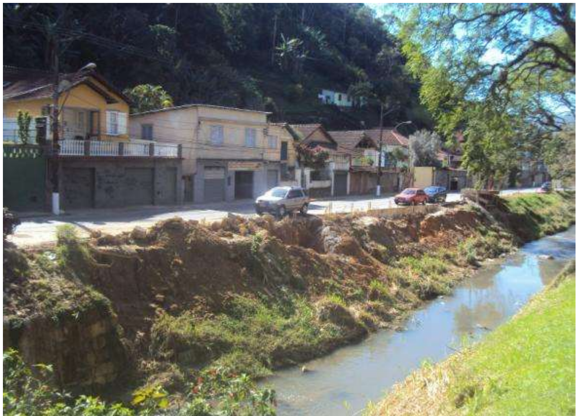
Obra abandonada na Rua Bingen
